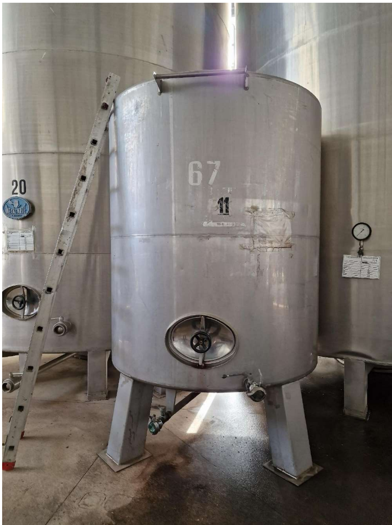
45- SERBATOIO APERTO DA L 2000
