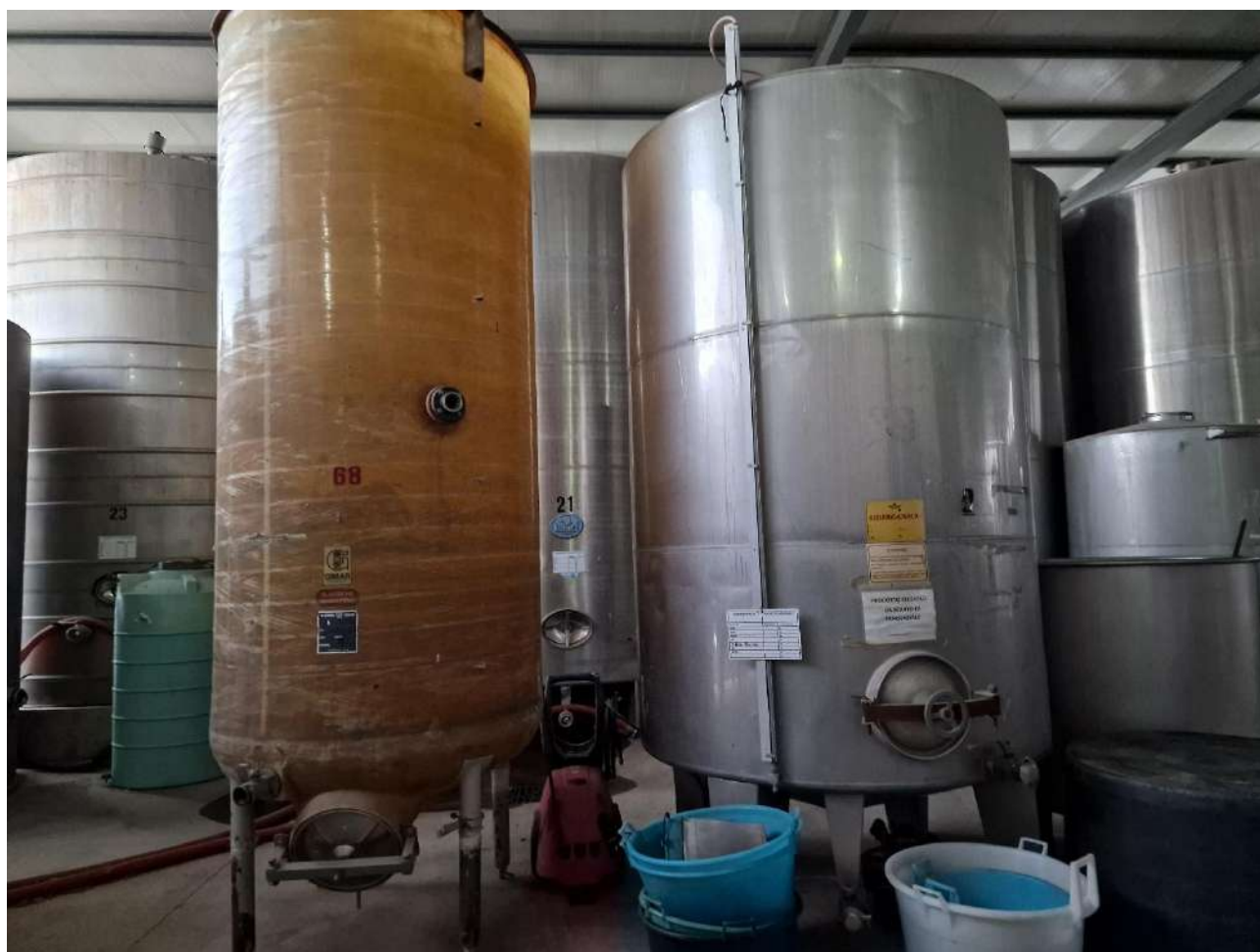
37- SERBATOI VETRORESINA DA 50 HL
