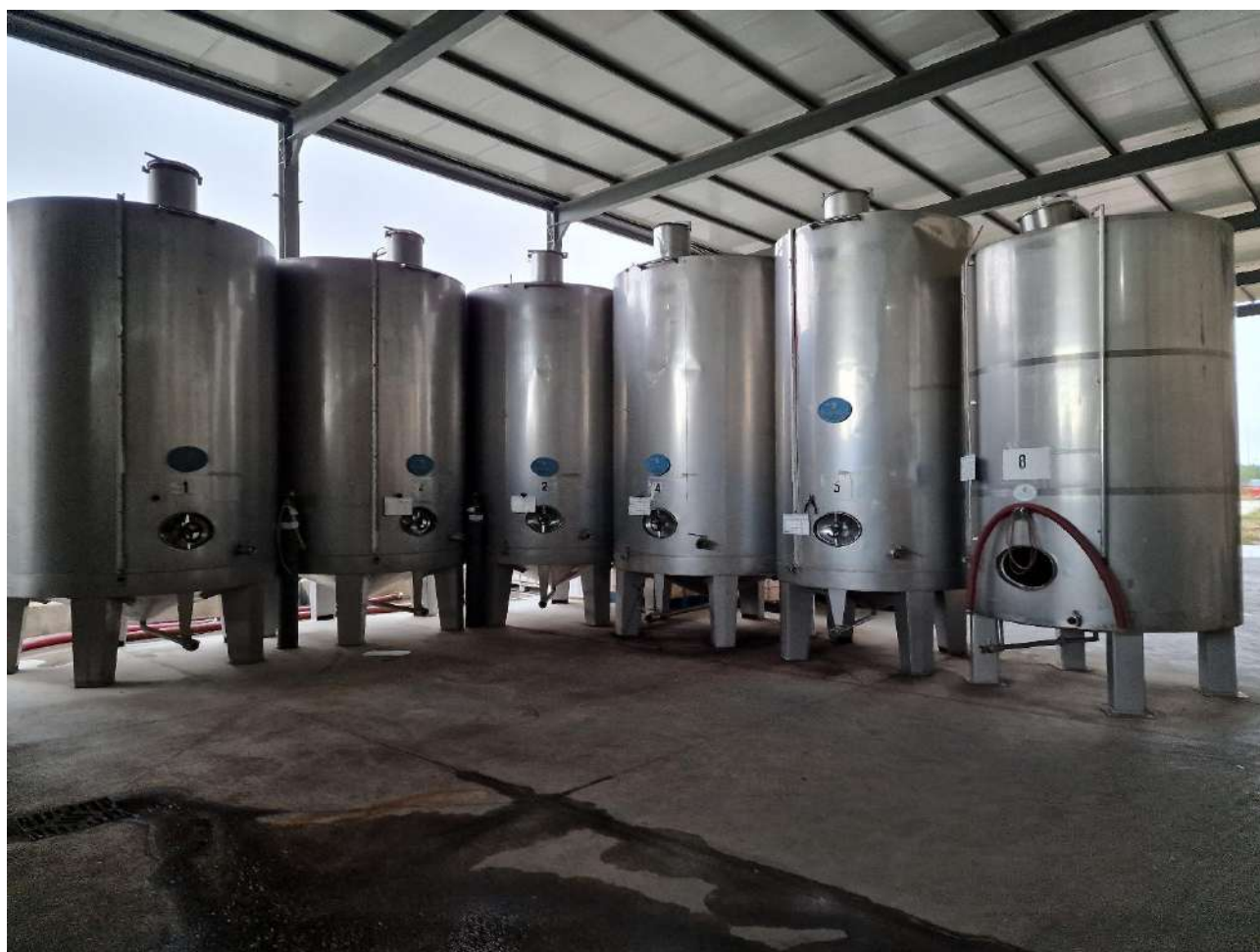
39-40- SERBATOI DA 96-100 HL
