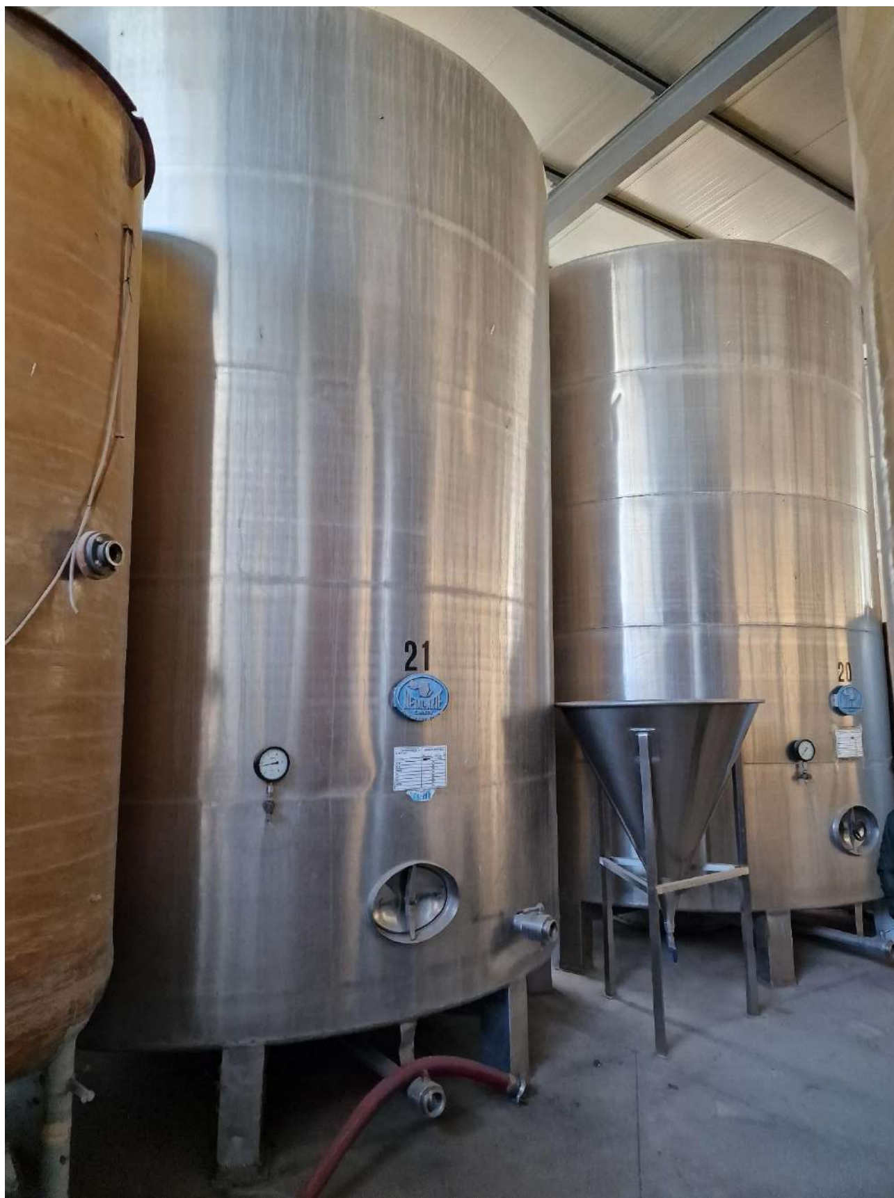
43- SERBATOI DA 600 HL
