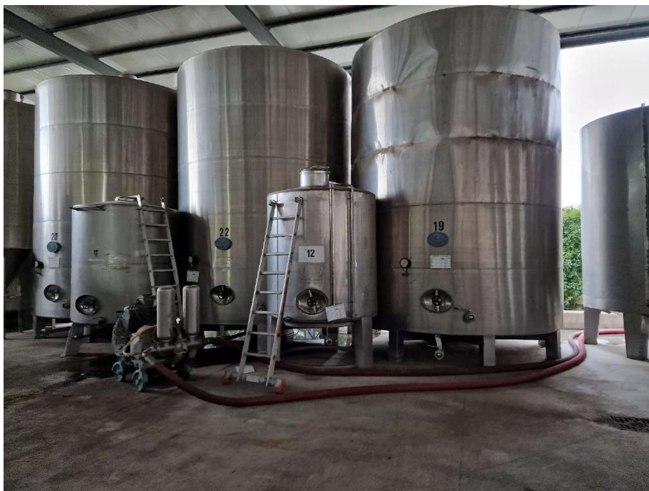
38- SERBATOI DA 150 HL
