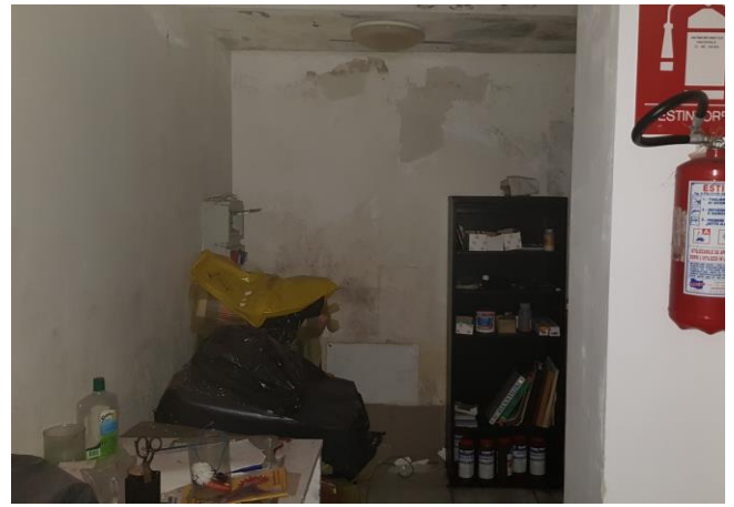
8. Stato di conservazione del deposito
