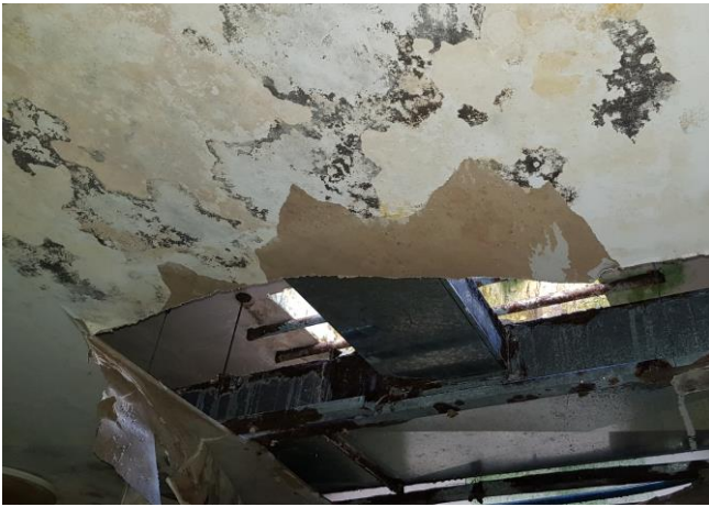
7. Stato di conservazione dei controsoffitti
